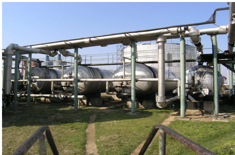
Слика 2. Резервоари за складирање на битумен
